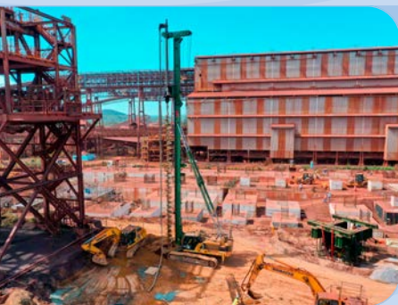
Execução de estacas Hélice Contínua, Escavada e Raiz. Canaã dos Carajás - PA, pela Tecnosonda.
