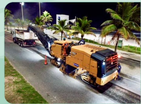
Fresagem de pavimento para o Programa Asfalto Liso, conforme o projeto da Dynatest, realizado com uso de levantamentos de Pavement Scanner e de Falling Weight Deflectometer (FWD), garantindo precisão e eficácia.
