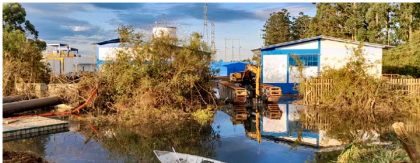
Para a retirada de entulhos e recuperação das ETAs, foram utilizados veículos anfíbios e guindastes, botes e estações flutuantes, ETAs móveis e bombas submersíveis
