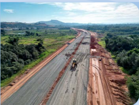
Construção de avenida na cidade de Pouso Alegre - MG, para melhorar mobilidade urbana no município. Esta obra foi executada pelo Grupo Duro na Queda.
